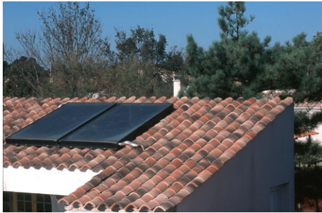
Capteurs solaires intégrés sur toiture neuve, Chéray
