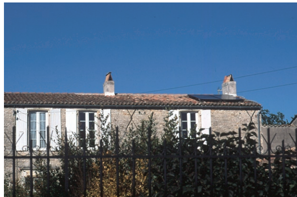
Capteurs solaires sur toiture ancienne
